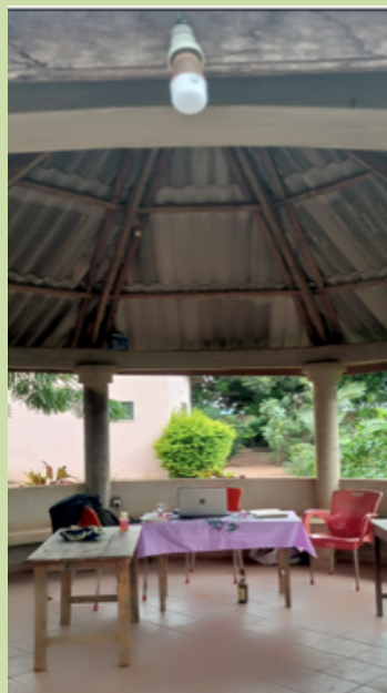
Vue de la paillette avec des lampes à l'intérieur et à l'extérieur
